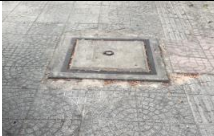
Hình 3.3 Hồ ga thoát nước thải
